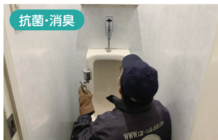
店舗内トイレ (セブイレブン仙台砂押店様、太白区)
